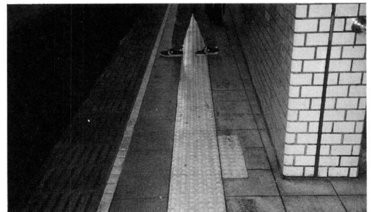
③構造上、狭いプラットホームに点字ブロックが敷設されており、転落や電車との接触の危険度が高い。
