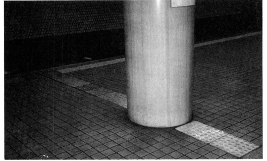
①プラットホーム端末の位置表示と思われるが、誘導路と間違えた視覚障害者が柱によって方向感覚を失う可能性が高い。
