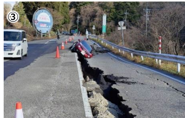
③ 国道249号 穴水町志ヶ浦
