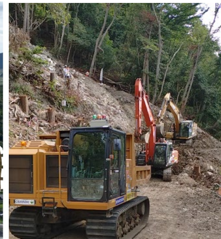
至 輪島市街 斜面中腹での崩土堆積状況 無人BH(遠隔操縦)による急峻な斜面中腹部での崩土撤去作業
