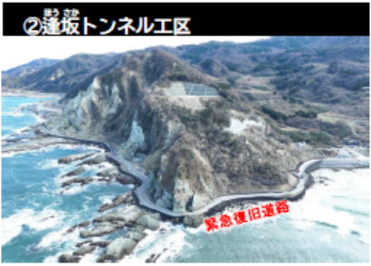
◆ 海岸隆起部を活用 ◆ 一般車両を含め1車線通行確保済(R7.12.23)
