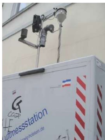
図 4-74 大気汚染の監視装置
