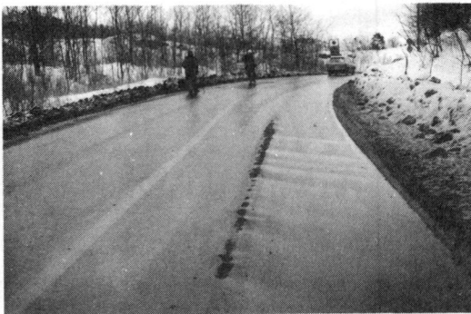
Fig. 7 ダンプ車が進行しようとした路面、Fig.6と同一路面(S.55.3.20日撮影) The same road on which the dumpcar was running
