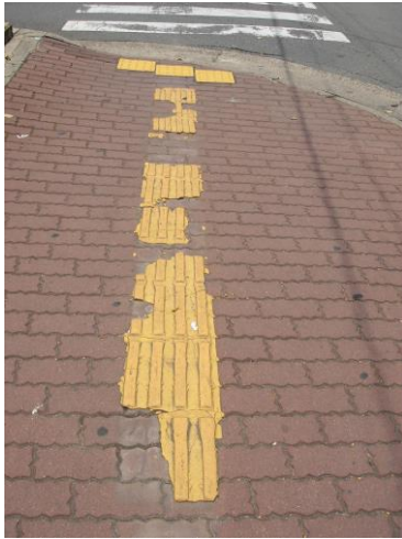
20-2 誘導ブロックが剥がれてしまい、誘導の機能が低下している。また景観を著しく損ねている。（奈良市）
