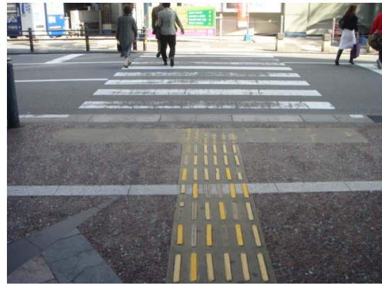
20-3 横断歩道前の警告ブロックの突起がなくなってしまうために、視覚障害者は横断歩道前であることに気がつかず、車道に飛び出す危険がある。（福岡市）
