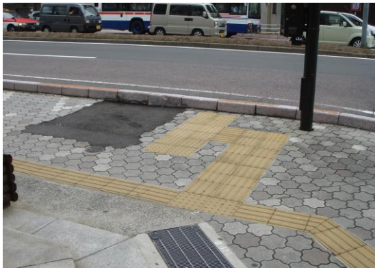
19-4 下が黒いコンクリートで埋められている部分には、以前は何らかの設備(おそらく電話ボックス)があったと思われるが、その設備がなくなっても点字ブロックはそのままにされている。設備を撤去した場合には、ブロックも修正しなくてはならない。(長崎市)
