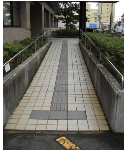
14-3 このケースのようにスロープ上にブロックを設置することは適切ではない。（宮崎市）
