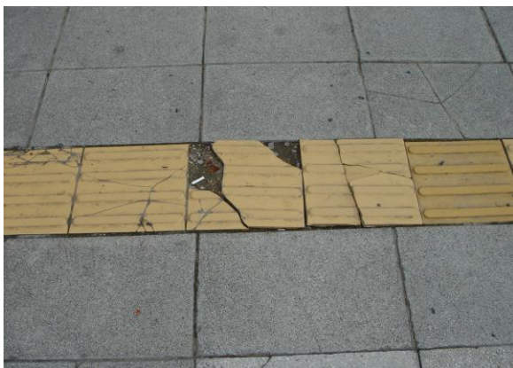
20-5 ブロックが破損したまま放置されているケースである。（韓国・ソウル）
