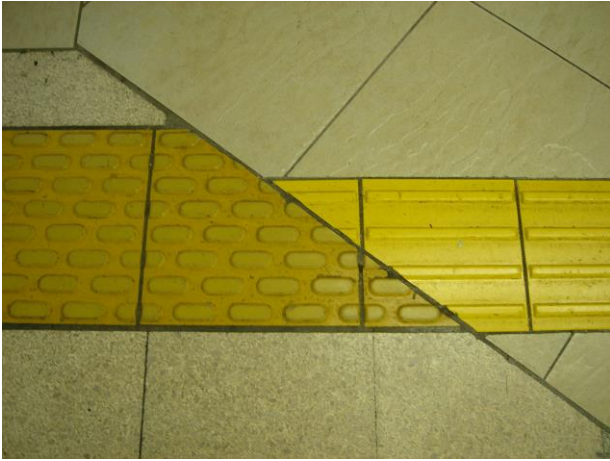
3-1 このケースは左右で管轄している機関が異なっており、このような状況になっている。この2種類のブロックはどちらも誘導ブロックであるが、左側の小判型の形状のものは点状の警告ブロックと誤認されやすい。特に、右方向から左方向に歩く場合ではその可能性が高い。 (東京・新橋)
