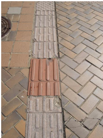
20-8 点字ブロックを補修する際に、元のブロックと違う種類のブロックが用いられることがよくある。ブロックの規格や形状が変わることによって視覚障害者が混乱することになる。また、ブロックの統一感がなくなり、景観を損ねる。(福岡市)
