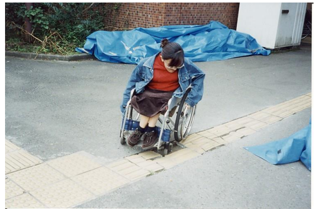
20-6 ブロックの破損部分は視覚障害者が困るだけでなく、車いす使用者等の大きなバリアとなる。
