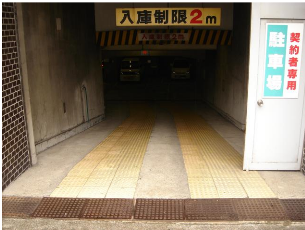
22-1 地下駐車場の入口で、車の滑り止めとして点字ブロックを用いているケースがある。(和歌山市)
