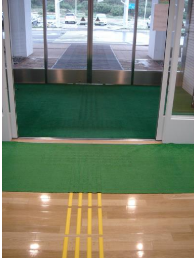
21-5 施設の入口の点字ブロック上に、泥除けのためにマットを敷いているケースがしばしばある。しかし、マットによってブロックの突起が確認しづらくなるため、ブロック上にマットを敷いてはいけない。（奥尻空港）
