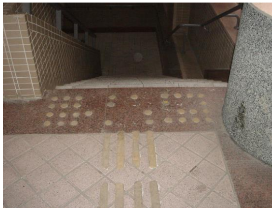
20-4 階段前の警告ブロックの突起がなくなったために、視覚障害者は階段前であることに気がつかず、転落する危険がある。（台湾・板橋）
