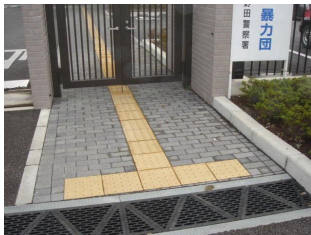
13-1 門の前に警告ブロックを設置すべきである。（千葉県野田市）
